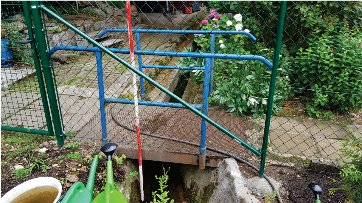
Abbildung 6.6: Hüssiger Bach bei km 0+183 mit Steg Nr. 7, Maschendrahtzaun und Gießkannen
