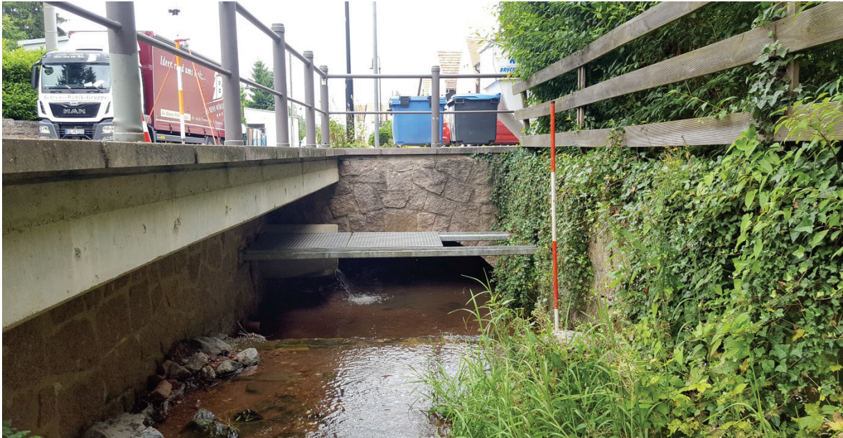
Abbildung 6.3: Einlauf der Verrohrung des Lotzebachs bei km 2+607, Talstraße links
