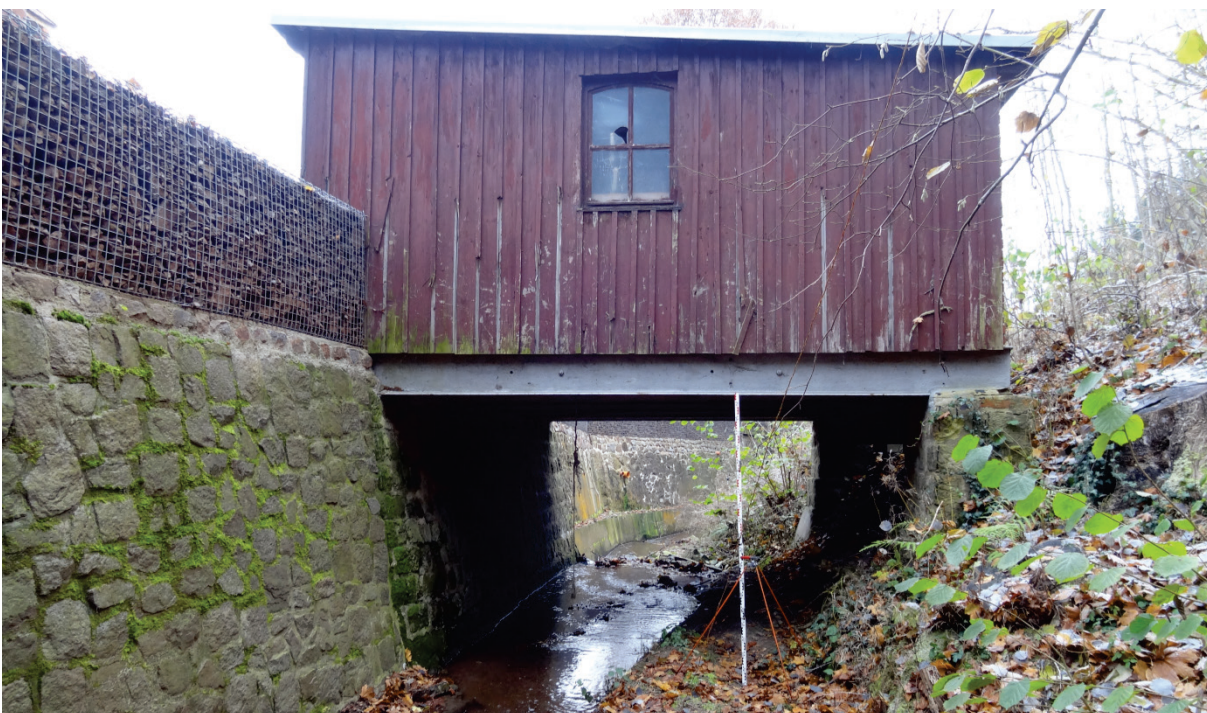
Abbildung 6.11: Einlauf der Brücke Nr. 4 mit Überbauung bei km 0+255 in Höhe des Grundstücks Weistropper Straße 3 mit linksseitiger Gabionenwand
