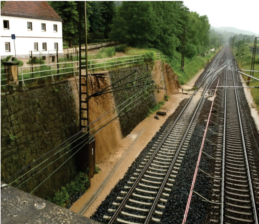
Abbildung 6.5: Abströmungen über die Stützwand am Lotzebachknick auf die Bahngleise im Mai 2014; Quelle: /5/
